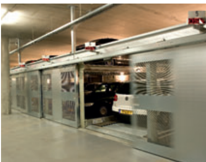
13 ... und öffnet das Schiebetor Nr. 6. ... and opens sliding gate 6.
