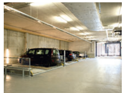
18 Die Sondersteuerung stellt sicher, dass die Besucherplätze immer direkt befahrbar sind. The special control ensures that the visitor parking spaces can be used immediately.
