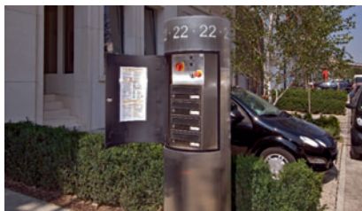
04 | B Die Stele mit Hausnummer, Briefkästen, Bedienelementen des Parksystems und Bedienungsanleitung. The system operation device with panel is installed inside a stainless steel post together with house number and letterbox making operation convenient for the user
